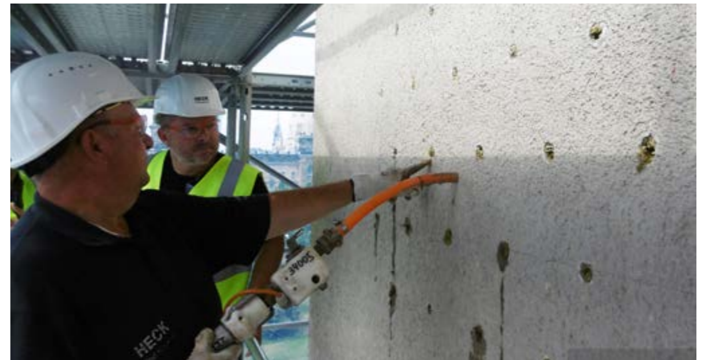
Avant l'application de l'isolation externe ROCKWOOL, les ouvriers ont injecté du mortier derrière l'ancienne couche d'isolation en laine minérale sur toute la façade.
