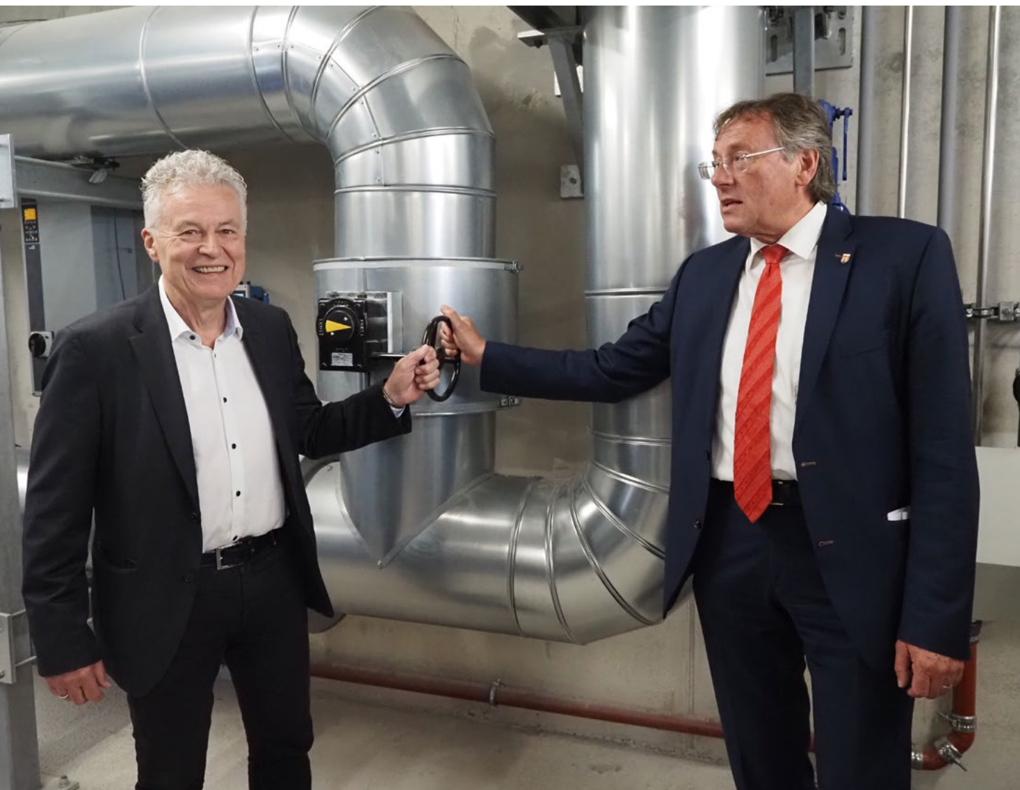
Volker Christmann (ex SVP de ROCKWOOL Europa Central, actualmente jubilado) y Bernhard Gmehling (alcalde de Neuburg) inauguran el nuevo sistema de recuperación de calor residual.
