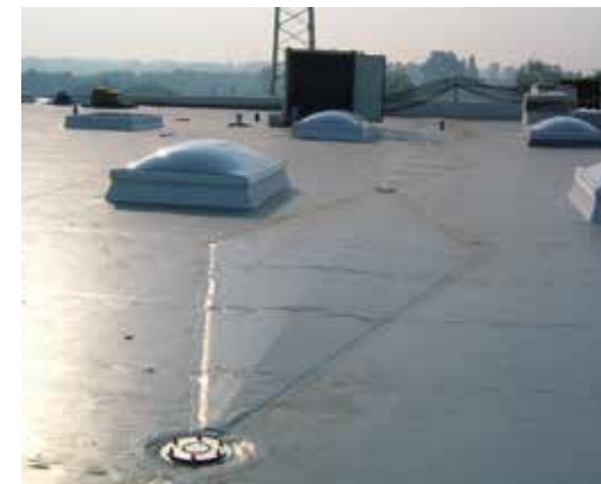
Punktentwässerung entlang der Kehllinien
