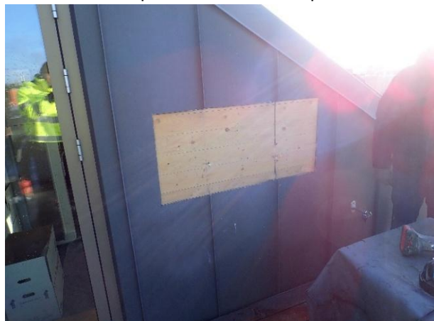
Bilde A.18 Det ble målt en avstand mellom spikerrekker på ca 35 cm. Det ble konkludert med at det ikke ville være mulig å ta ut en stor nok prøve.
