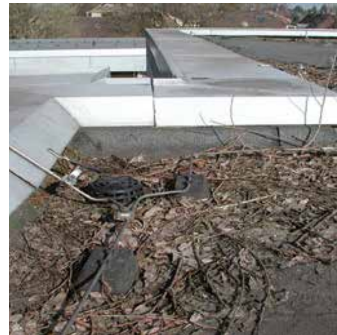
Regelmäßige fachgerechte Wartung verhindert Folgeschäden
