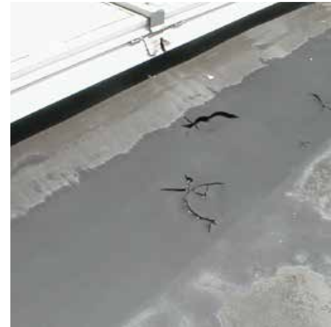
Materialschäden erfordern eine Dachsanierung
