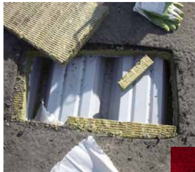
Bei Undichtigkeiten Dämmstoff auf Feuchtigkeit überprüfen
