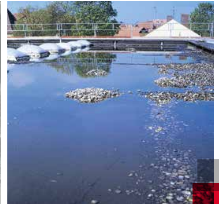
Stehendes Wasser auf einem Null-Grad-Dach
